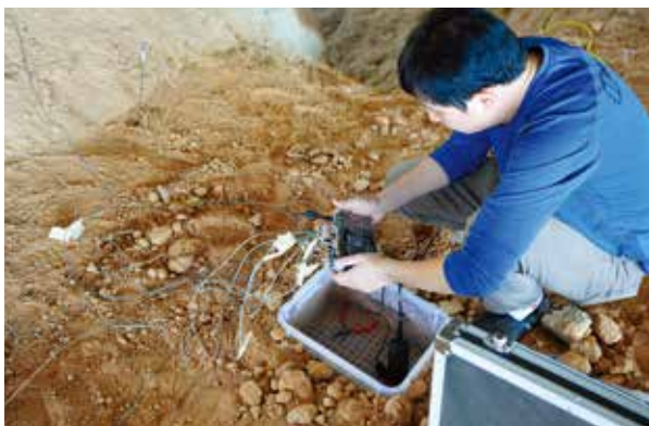
사진 218 다채널 온도측정기 설치
